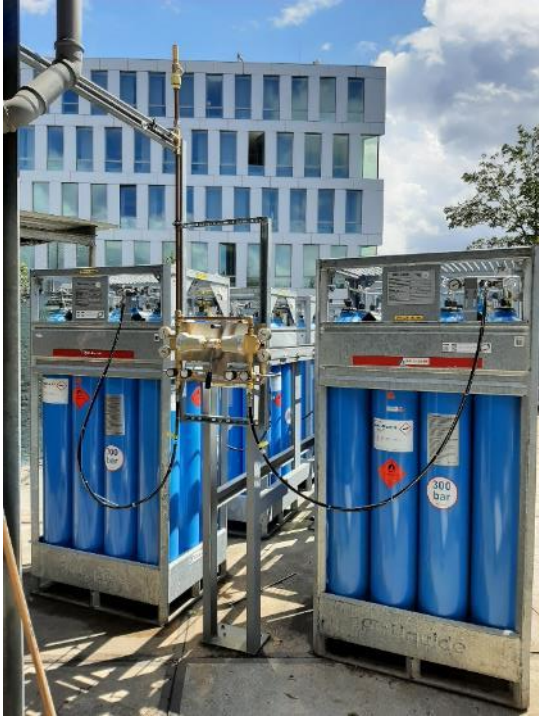
Wasserstoffversorgung mit Bündeln
