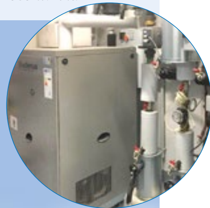
Gasabsorptionswärmepumpe im Heizungskeller. Bilder: Prof. Thomas Giel
